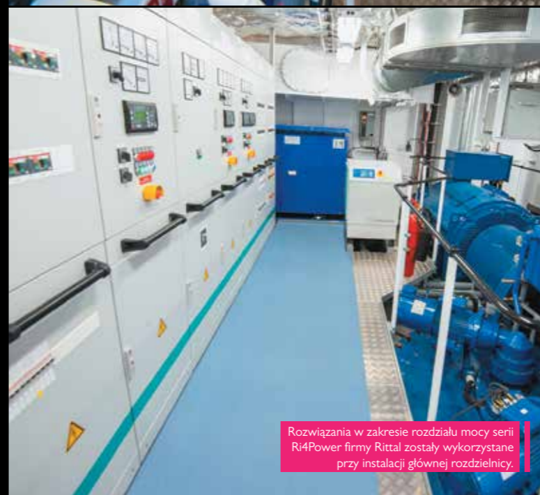
W maszynowni promu Ostfriesland wykorzystano wiele standardowych obudów sterowniczych serii AE firmy Rittal w celu zapewnienia zdecentralizowanego rozdzielni systemów instalacyjnych.
