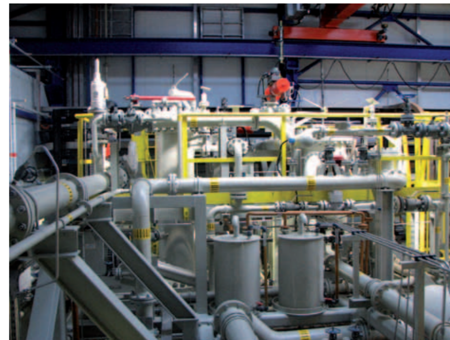
Kompresory gazu kwaśnego – zaprojektowane i zbudowane przez ABB – stanowią jeden z najważniejszych elementów całej instalacji. Gaz ten, zawierający kilkanaście procent siarkowodoru, pozwala bowiem na odzyskanie lekkich węglowodorów niezbędnych w technologii związanej z przerobką ropy naftowej. (Fot. Sławomir Cieślak)
